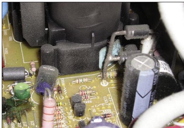
Foto 16e - Dal punto di vista elettronico, porre due diodi in parallelo diretto è davvero difficile e pericoloso (a causa della caratteristica esponenziale della corrente!). Questo è comunque un aspetto che è stato valutato a dovere dai progettisti della ProView
