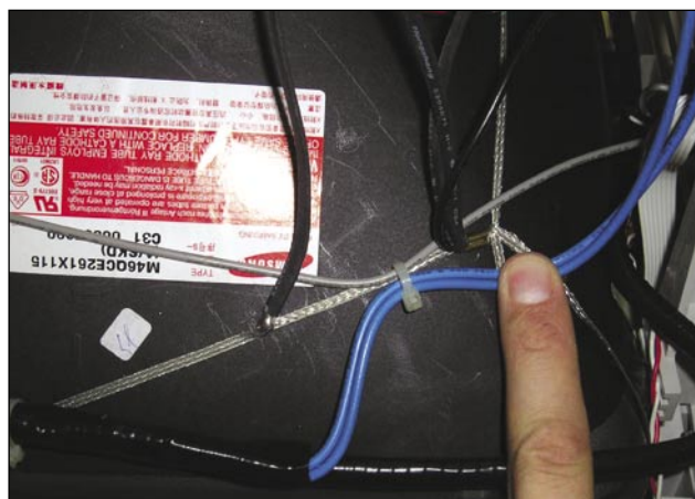
Foto 5 - Particolare del morsetto di massa relativo alla calza schermo del TRC
