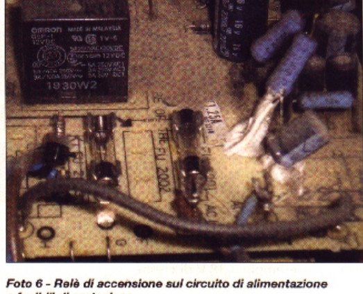
Foto 6 - Ruolà di accensione sul circuito di alimentazione e fusibili di protezione
